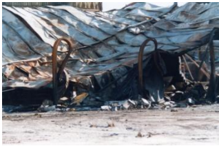
Nave después de un incendio.
